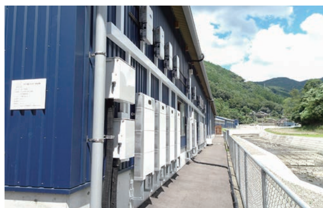
蓄電池を設置することで夜間や災害時にもクリーンエネルギーが使用できる
